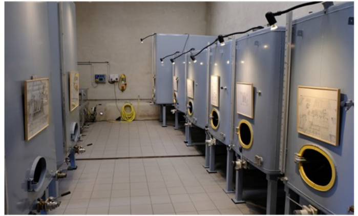
CUVERIE de DÉBOURBAGE
